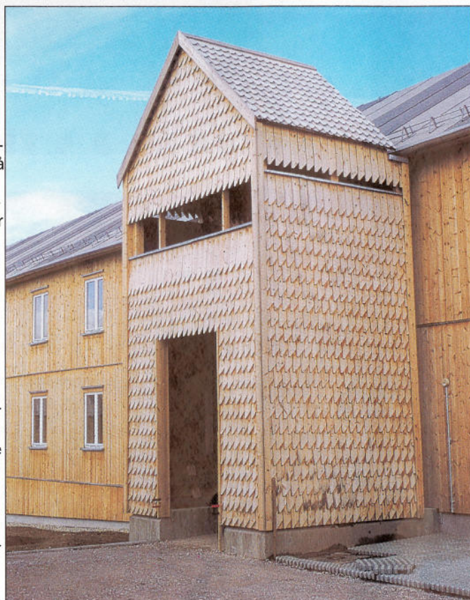
Trespon brukt på et inngangsparti til mannskapsforlegningen i Rena leir. Selv med et enkelt skrånende i enden får veggflaten et livfullt mønster.
